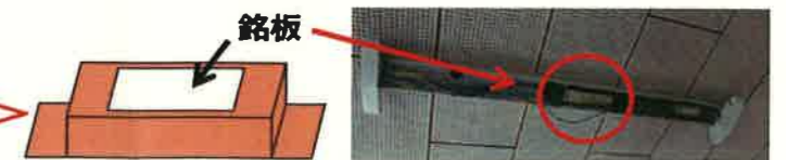
蛍光灯の安定器
